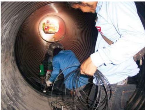
เชื่อมต่อภายในด้วยลวดเชื่อมพื่อ ระบบลมร้อน ไม่มีการรั่วซึม
