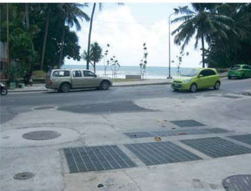
วางท่อเสร็จ ปิดผิวถนนพร้อมใช้งาน (ท่อ PROPIPE สามารถรับแรงกดทับได้ถึง 10 ตัน/m2 จึงไม่มีปัญหาเรื่องถนนยุบหรือท่อหักกลางเนื่องจากดินทรุดตัว)
